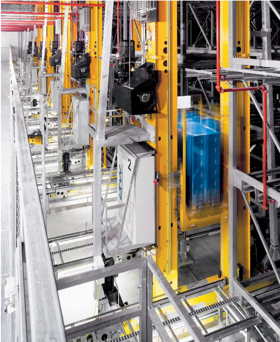
Blick in das 26 000 Palettenplätze fassende vollautomatische Versand-Hochregallager, mit dem die bestehenden Kleinteile-, Hochregal- und Vorratslager im Jahr 2009 erweitert wurden
